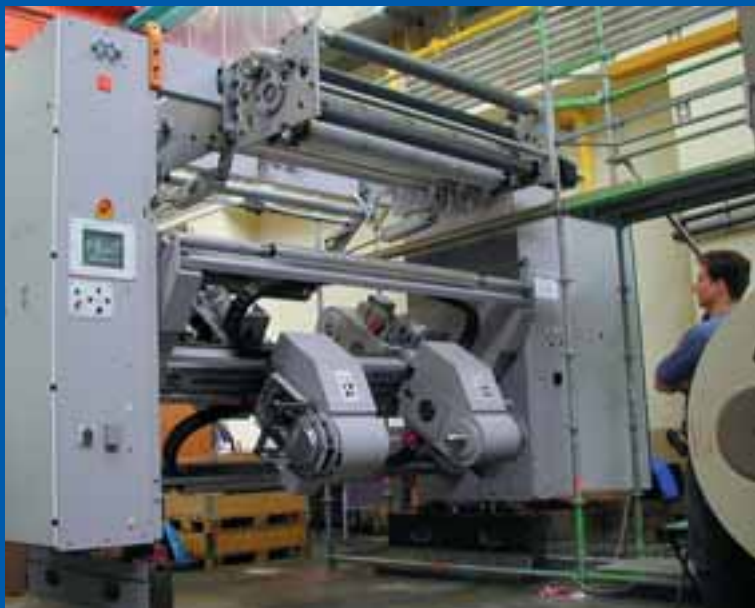
Diese Anlage der Papierindustrie wurde mit der Lenze 9300 Servo PLC ausgerüstet. Die Lenze-Antriebsregler kommunizieren mit der Steuerung über INTERBUS.
